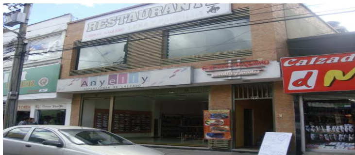
Registro Fotográfico Predio ubicado en la KR 20 No. 17 – 51. Localidad de Antonio Nariño El área disponible para estacionamientos en primer piso fue suprimida para destinarla a local comercial (venta de calzado)
